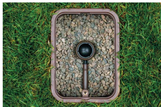
Nainštalovaný automatický preplachovací ventil
